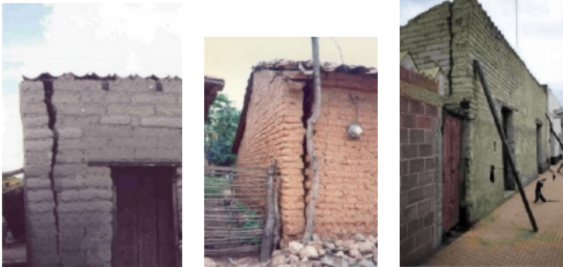
Figura 6.3 Agrietamiento vertical en esquinas (Juárez y otros, 2000)
