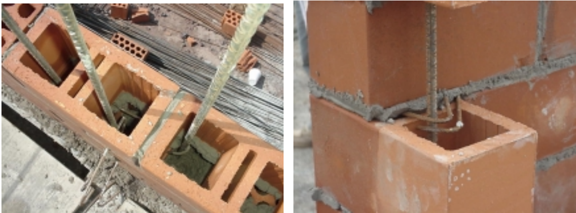
Figura 10.4 Muro de piezas huecas con celdas reforzadas (nótese el uso de conectores)
