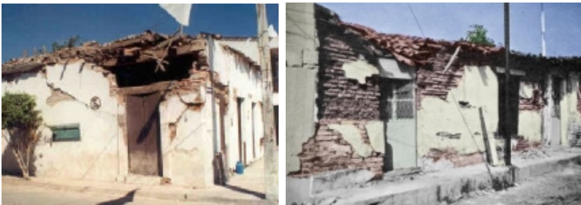
Figura 6.4 Daño en aberturas por falta de confinamiento (López y Teshigawara, 1997)
