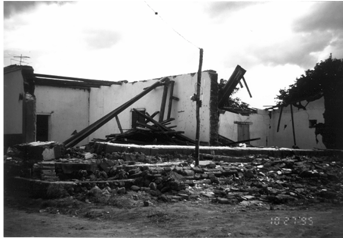
Figura 11.54 Falla de muros de adobe fuera de plano y caída de techo
