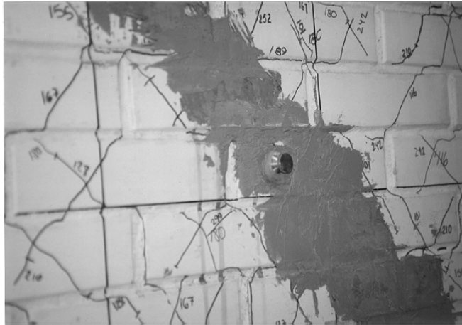
Figura 11.36 Preparación de la superficie de un muro de mampostería con resina epóxica
