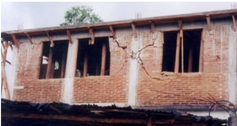
Figura 6.14 Daño en un segmento de muro no confinado
