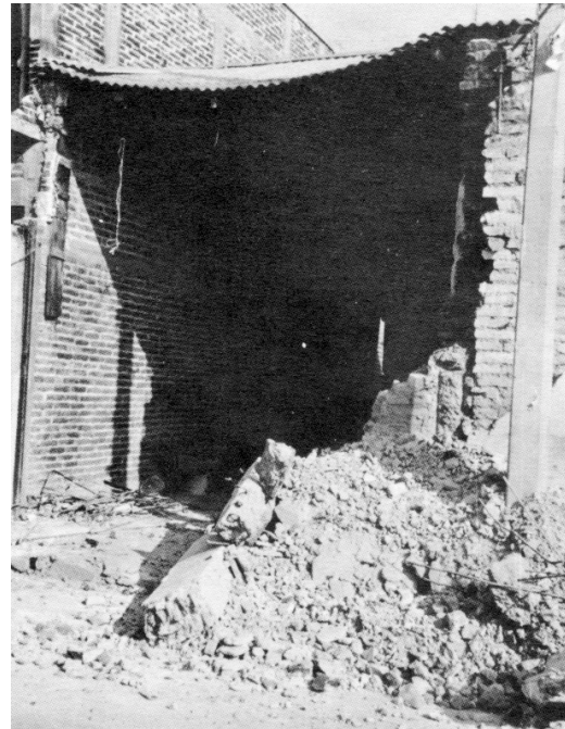
Figura 6.7 Inadecuada conexión de muros de mampostería con elementos confinantes (López y Teshigawara, 1997)
